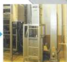
② 異物検査 異物検知装置で石や金属、不純物を検知し除去します。
